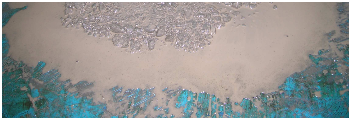
شکل ۴-۵ - بتنی با آب انداختگی
